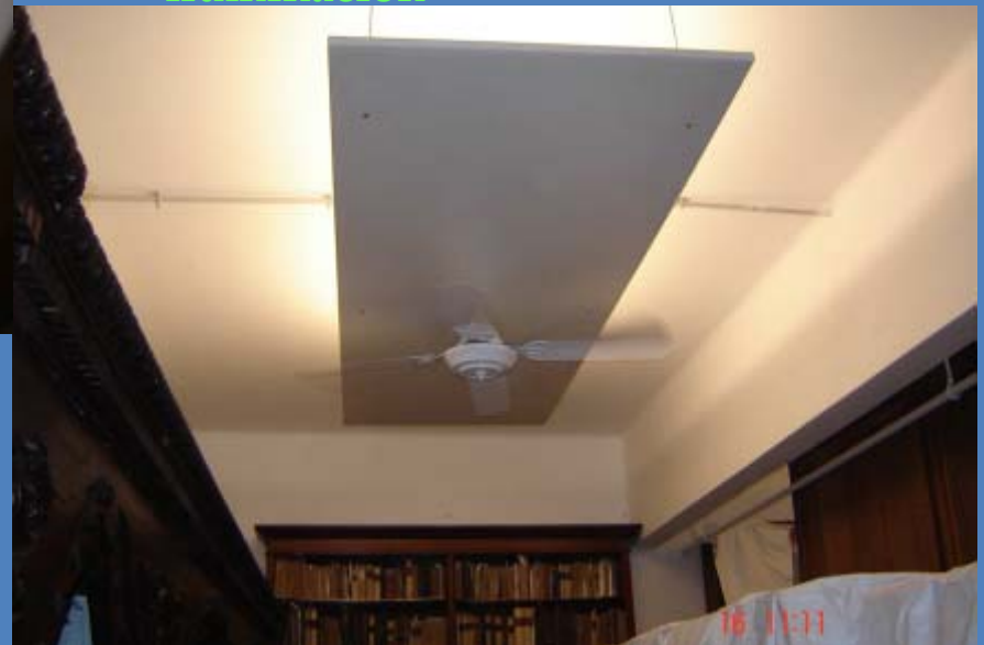
Ventiladores y nueva iluminación
